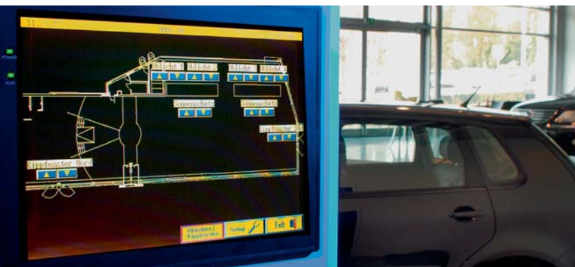
Infozentrale der Licht- und Beschattungssteuerung
