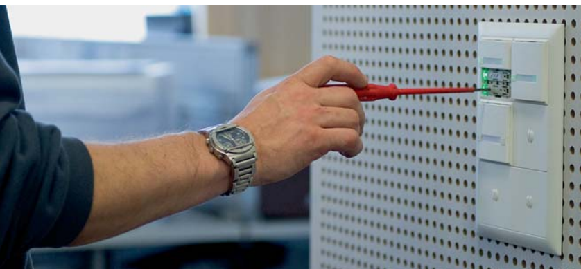
Zentrale Steuerung der einzelnen Module
